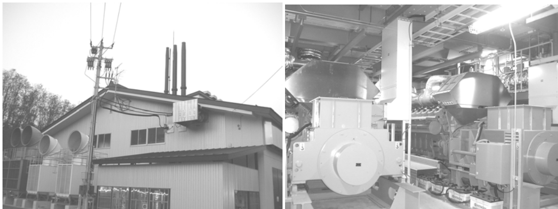
図5 やまがたグリーンパワー 施設外観(左)と発電機(右)
