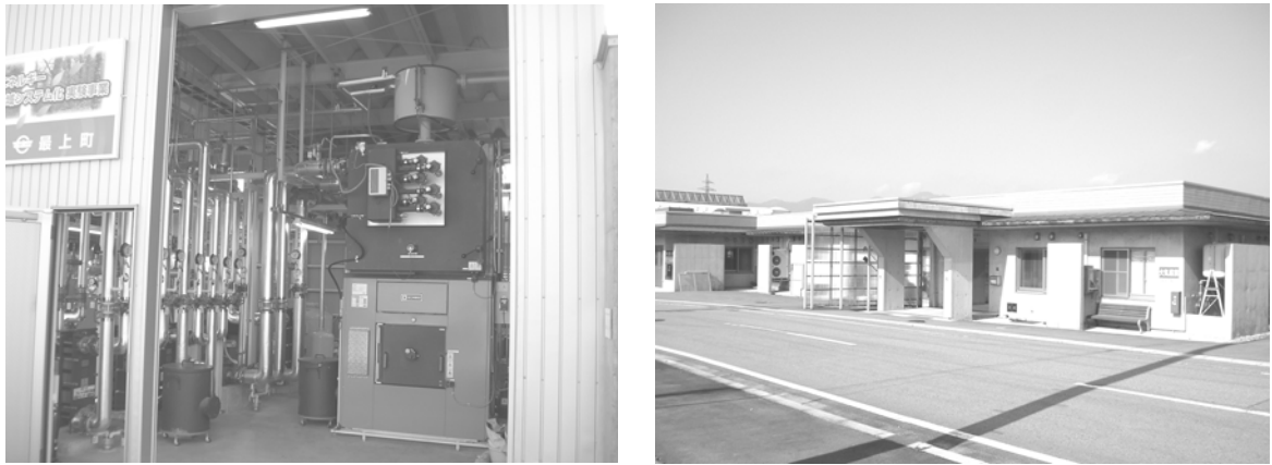
図7 バイオマスボイラー(左)と熱利用施設「ウエルネスタウン最上」(右)
